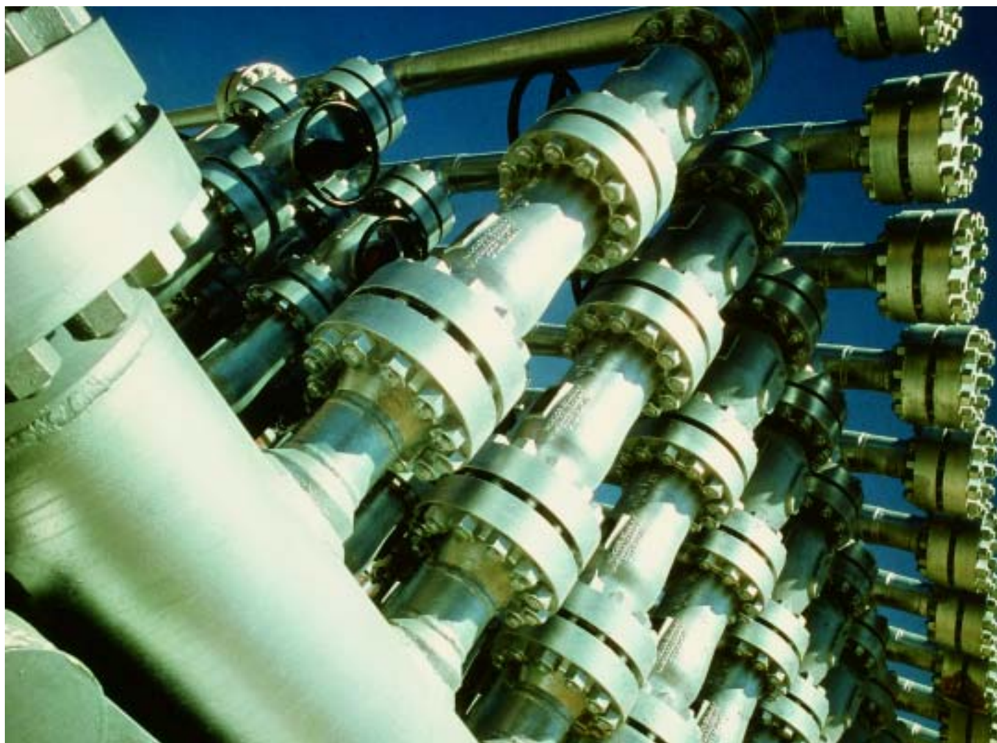
Отсечные и безударные обратные клапаны 6" ANSI 900 на коллекторе закачки воды в нефтяной пласт, северная Африка.
