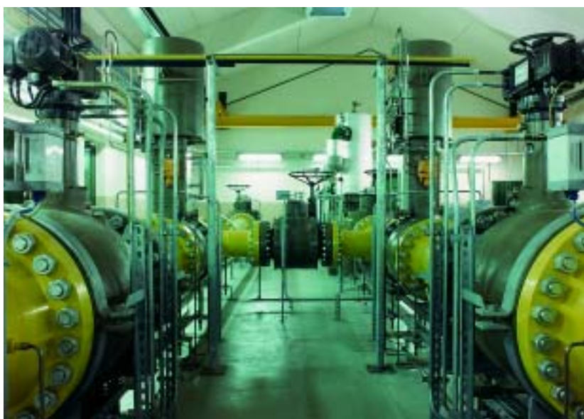
Клапаны регулирования давления и предохранительные отсечные клапаны на газоизмерительно-редукционной станции, Германия.
